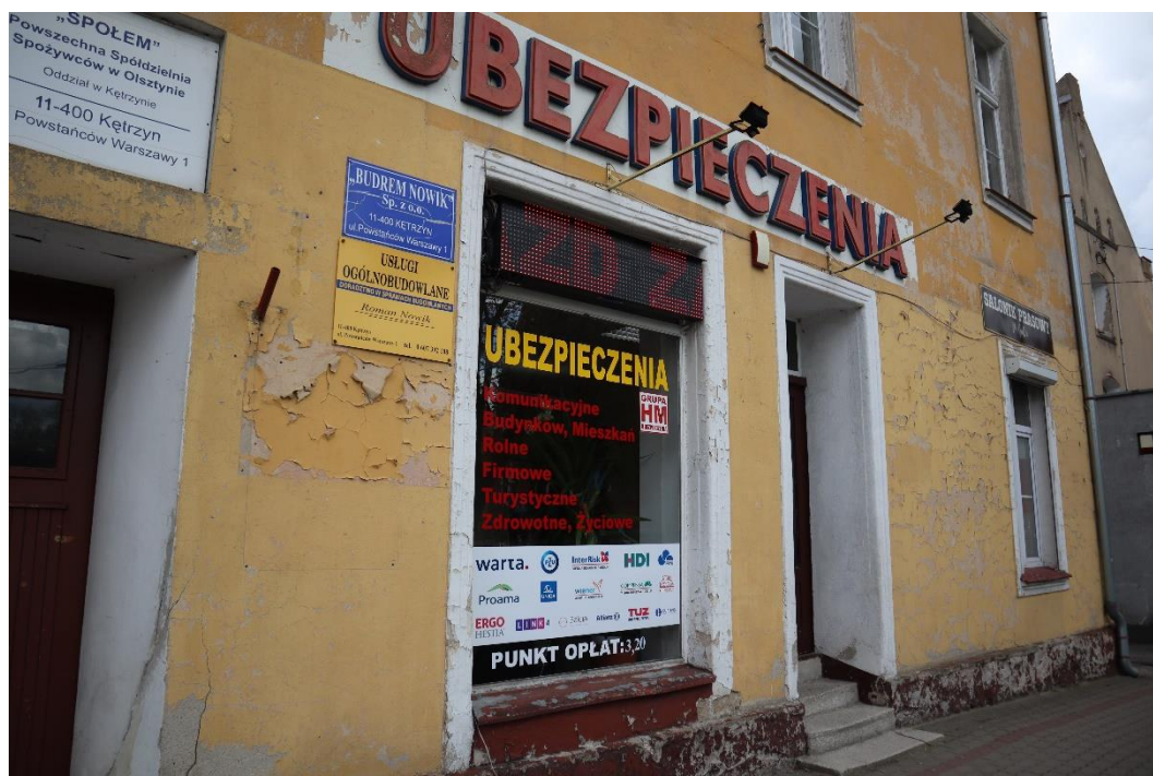
Fot. 3. Przykład lokalu użytkowego usytuowanego w budynku wymagającym remontu, ul. Powstańców.
